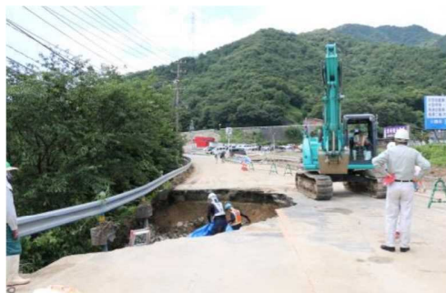
国道185号仁方町 崩土のため通行止
